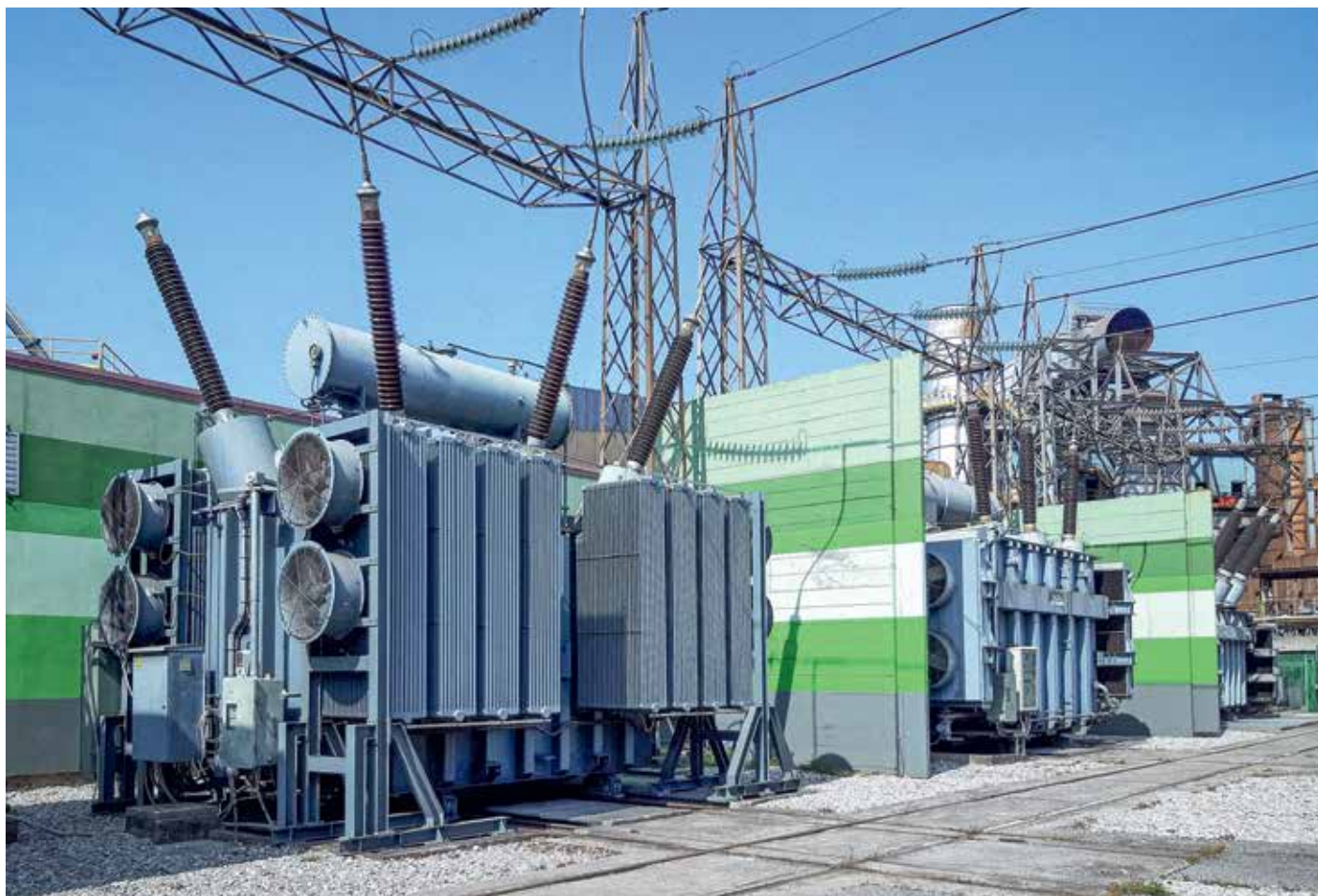
در مجموع ۹ دستگاه ترانسفورماتور ، تنظیم ولتاژ را در کارخانه ABS برعهده دارند.
